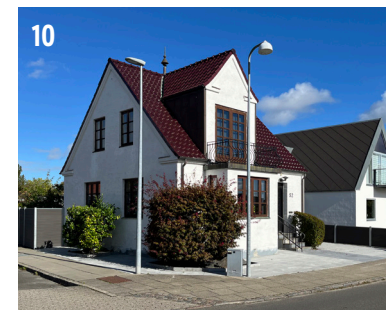
Sølystvej 52 I form af en enkelt vandskuring formår man skjule en 70'er skalmuring i gule mursten. Ejendommen fra 1927 syner nu mere original og har bedre sammenhæng med øvrig bebyggelse.
